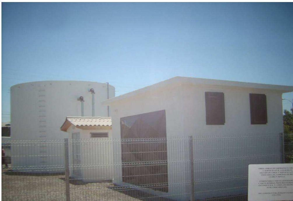
APR Chacarillas, VII Región: Estanque Presurizado, Caseta de Bombas y Generador
